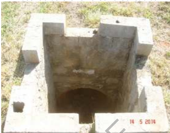
Ausência de Grelha na Caixa Construída
