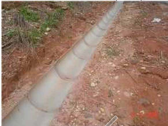
Canaleta Mal Executada (Juntas)
