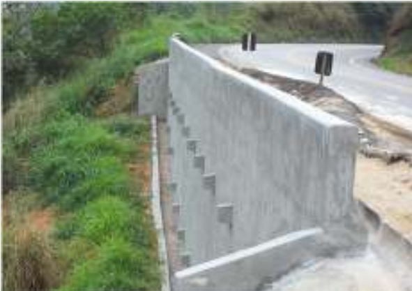
Cortina Atirantada - Manchas, Umidade, Trincas
