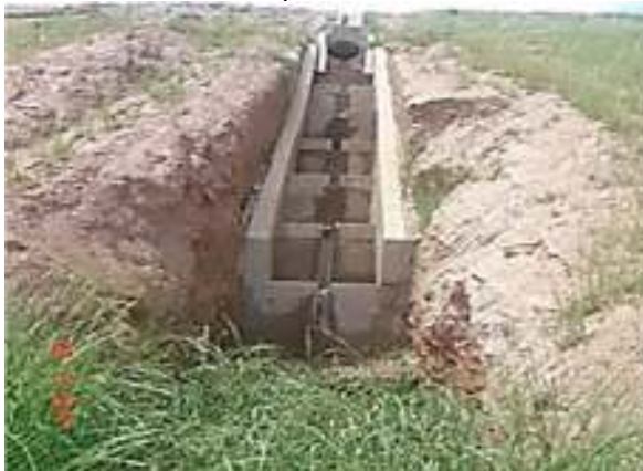
Ausência de dissipador e Reaterro Lateral
