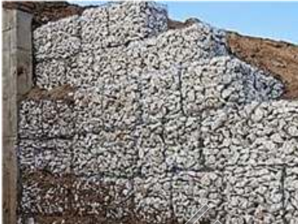
Gabiões – Perda de Finos, Desalinhamento
