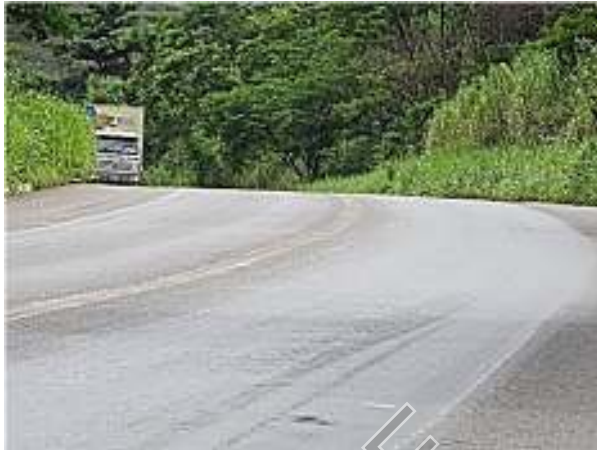
Falha em Pintura Horizontal – Perda de Visibilidade
