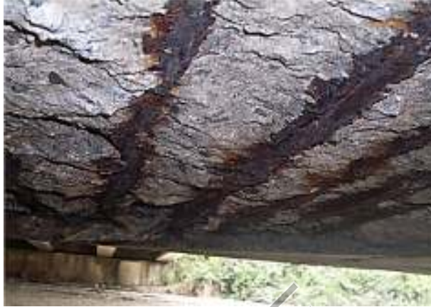
Armadura Exposta / Armadura Corroída
