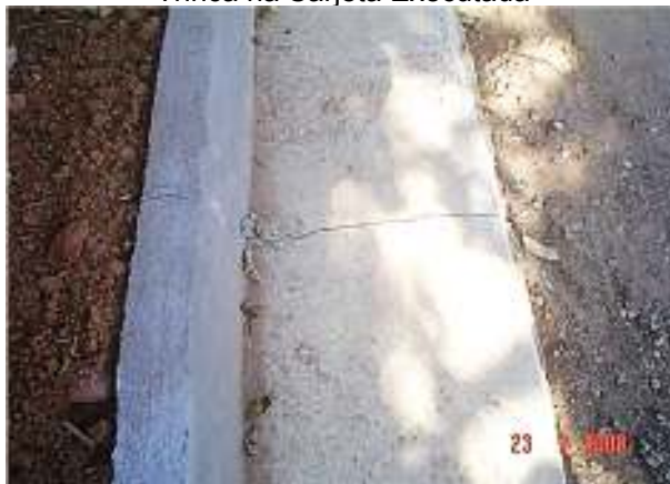
Trinca na Sarjeta Executada
